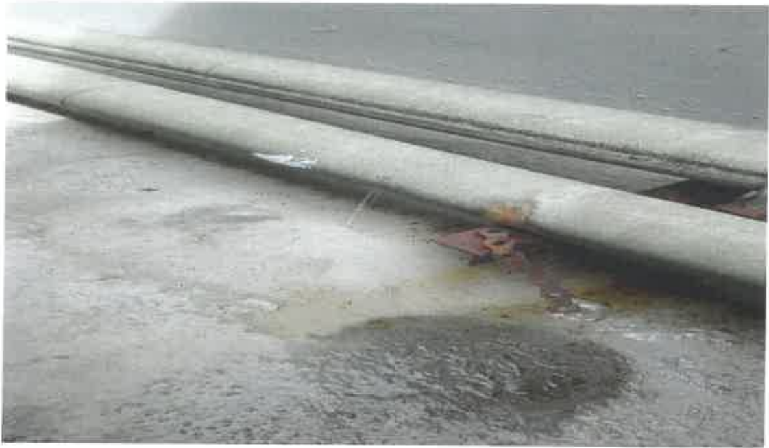
GAMBAR DIATAS : KEBOCORAN PAIP AIR (BAHAGIAN TENGAH)
