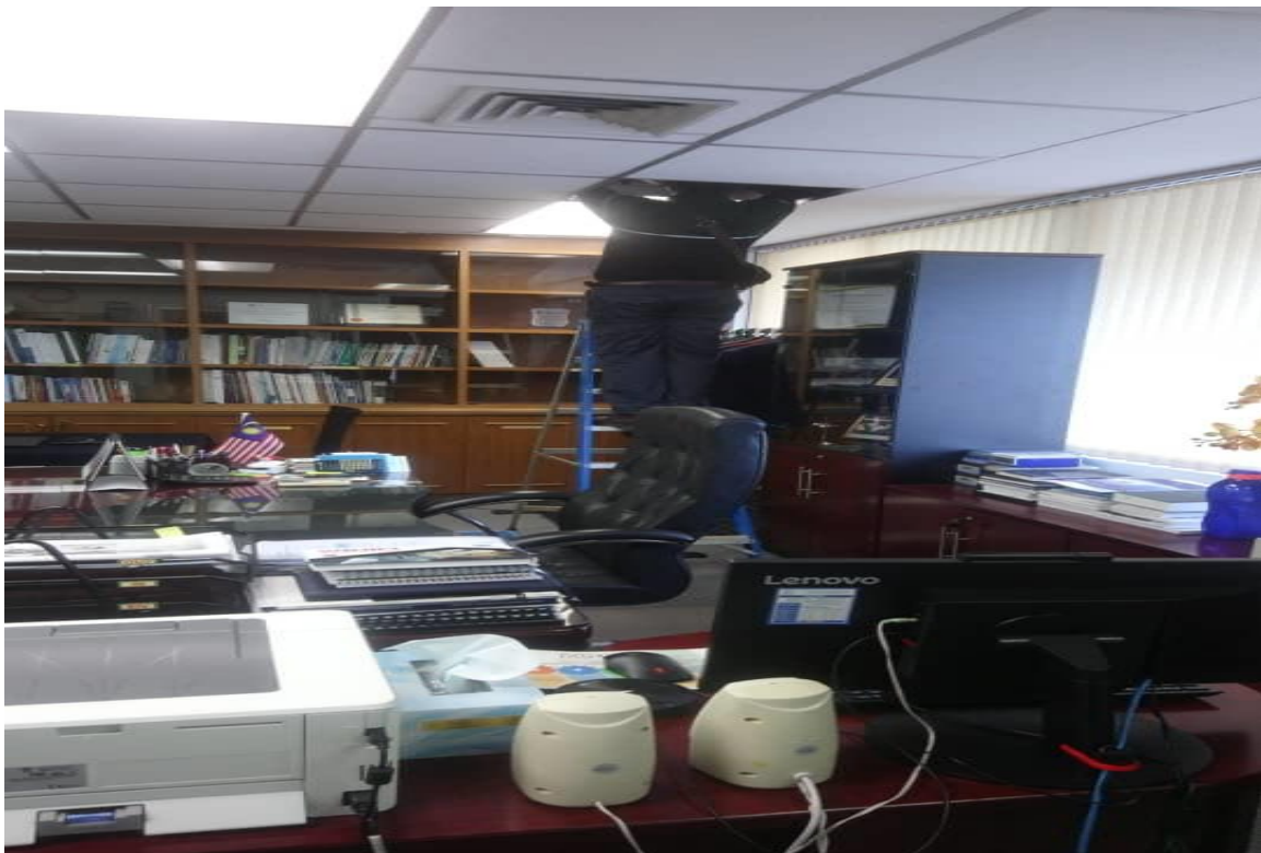
Gambar di atas: Lokasi punca kebocoran telah dikesan oleh kontraktor
