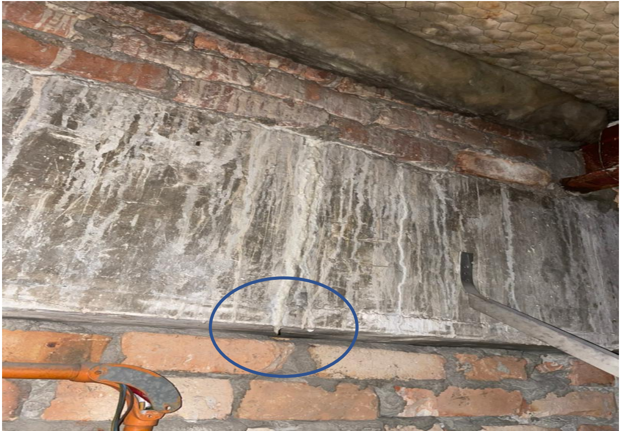
Gambar di atas: Lokasi baru punca kebocoran (dalam dinding) telah dikesan oleh kontraktor
