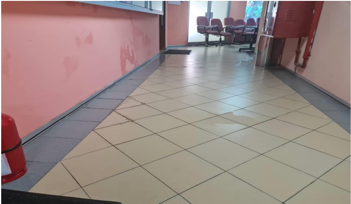
GAMBAR DIATAS : Kesan lembab di dinding & sedikit takungan air di lantai
