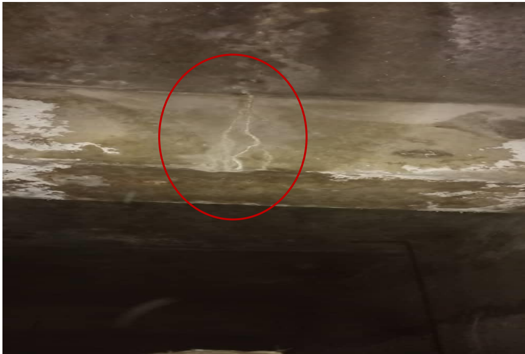
GAMBAR DIATAS : Kesan laluan air daripada slab (beam sebelah kanan)
