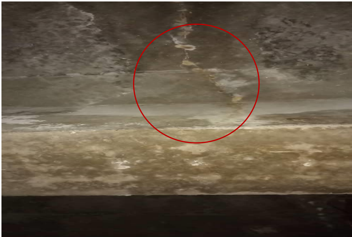
GAMBAR DIATAS : Kesan laluan air daripada slab (beam sebelah kiri)
