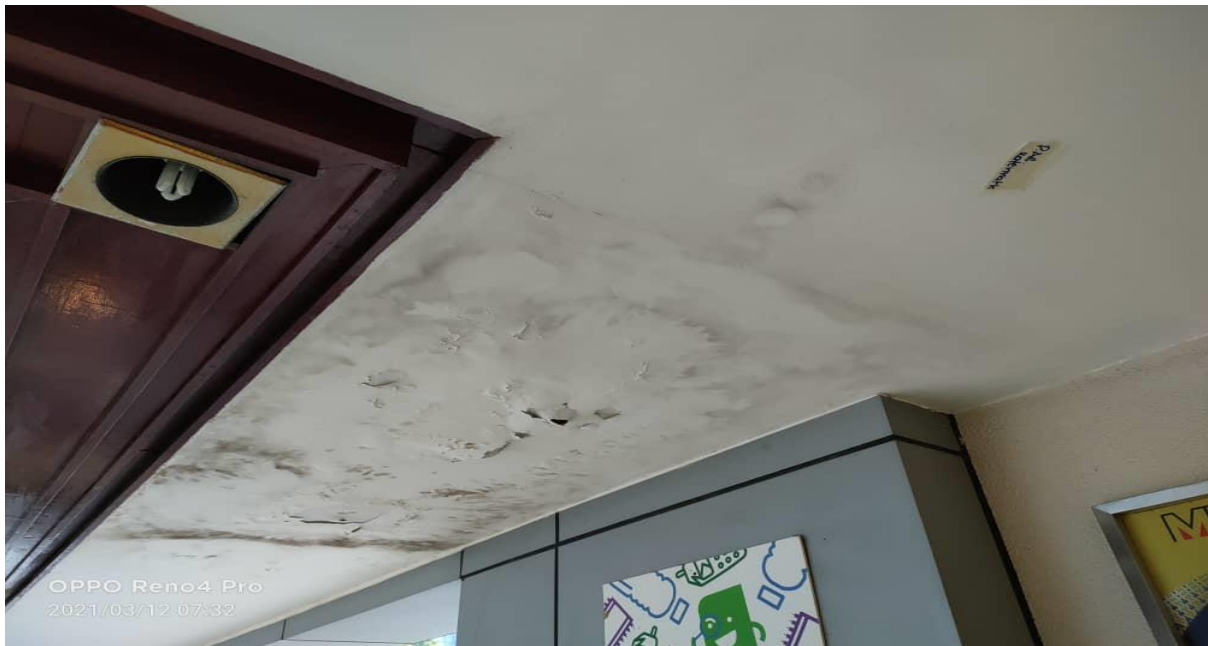
GAMBAR DIATAS : Kesan kebocoran air dari bumbung
