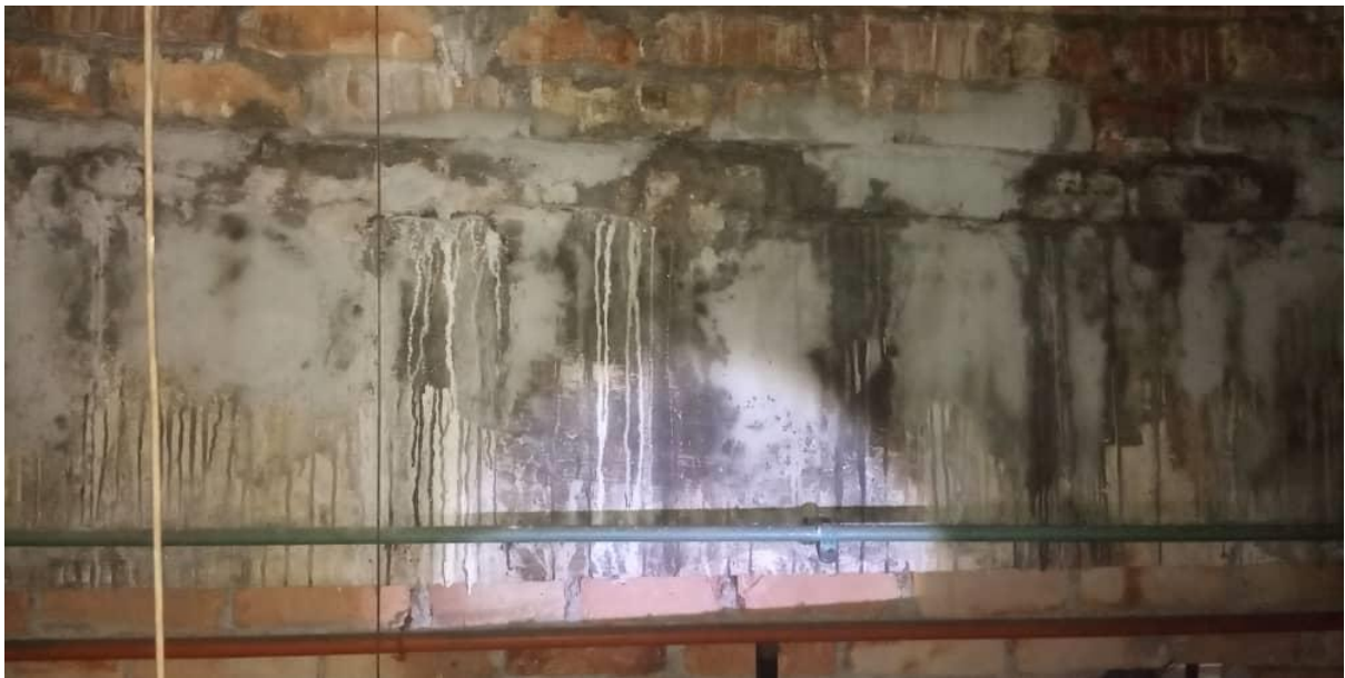
GAMBAR DIATAS : Kesan air keluar dari dinding di dalam siling gelembung tersebut. Disini kerja – kerja Grouting akan dilakukan (untuk menghalang air keluar dari dalam dinding)
