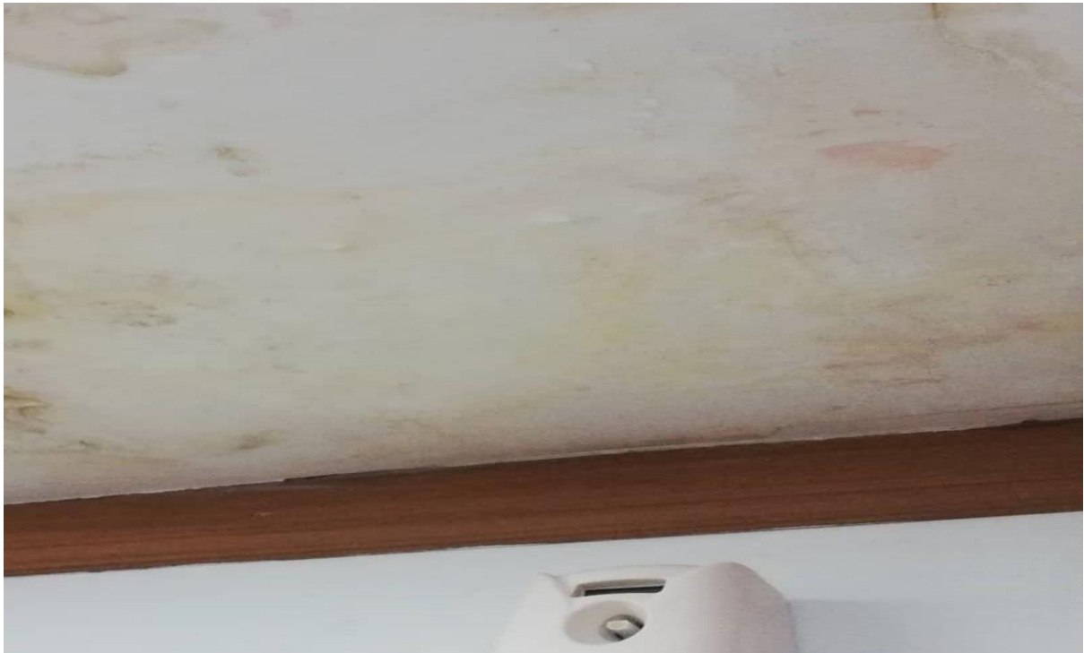
GAMBAR DIATAS : Siling menjadi kotor & gelembung kesan kebocoran air dari dalam siling
