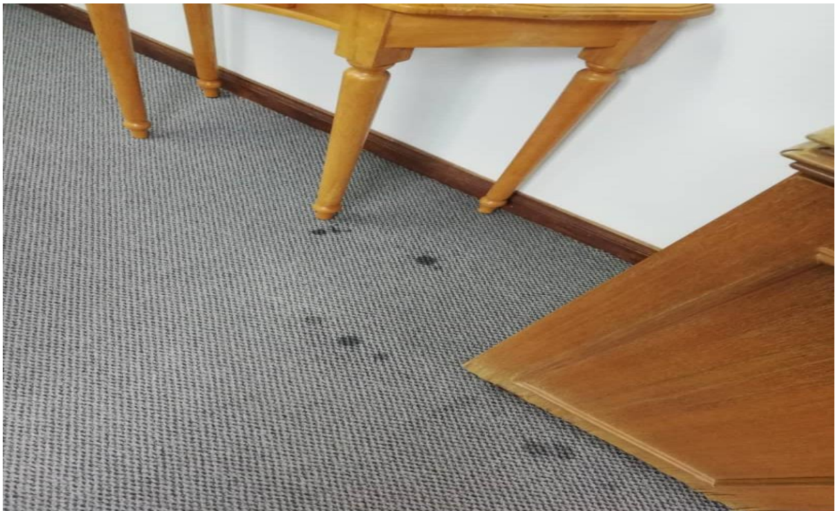
GAMBAR DIATAS : Kesan air menitik daripada kebocoran air dari dalam siling
