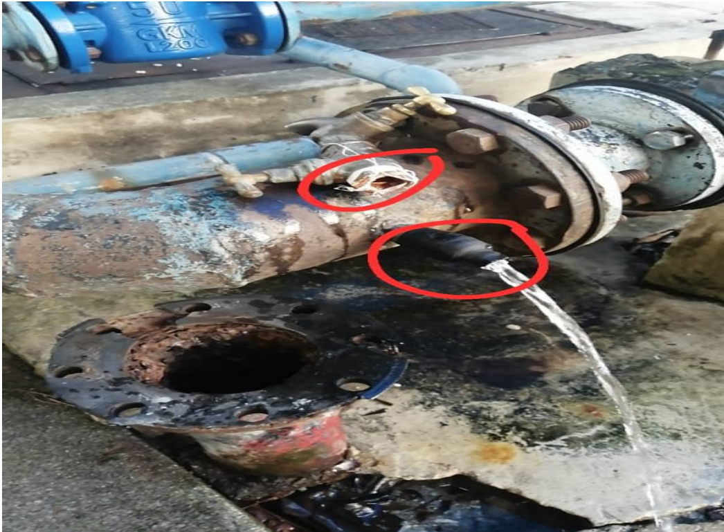
GAMBAR DIATAS : Paip saluran yang terlalu berkarat & patah, menyebabkan kebocoran
