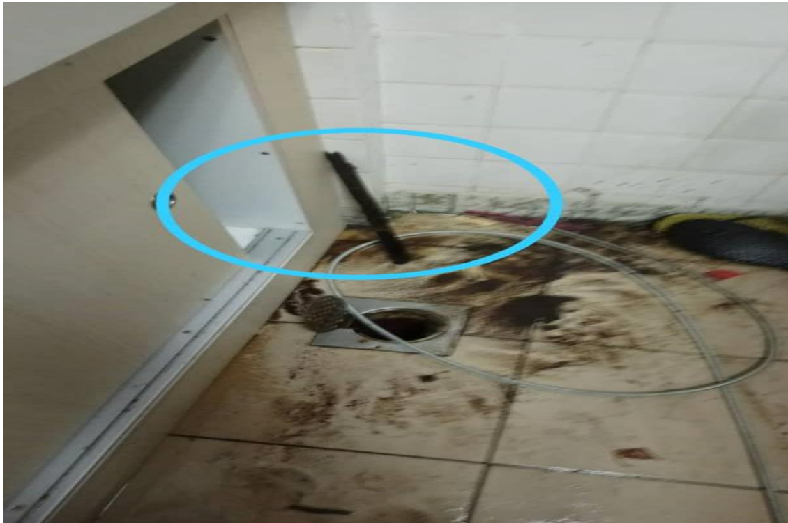
Gambar Diatas: Serpihan kayu (dalam bulatan) telah berjaya dikeluarkan dari dalam saluran lantai tersebut (Punca tersumbat)
