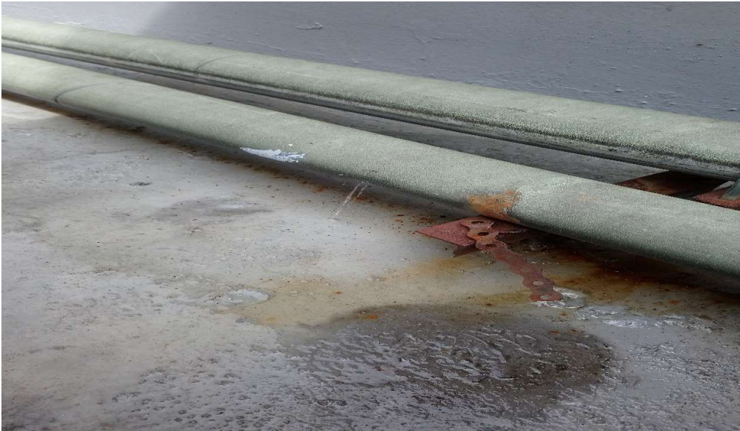
GAMBAR DIATAS : KEBOCORAN PAIP AIR (BAHAGIAN TENGAH)
